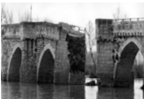
Id: I/FC-058/016 Título: Vista parcial del puente antes de la reparación
